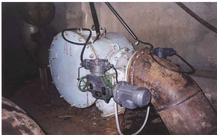
Рис. 2 Фильтр ФСО-400 на месте эксплуатации
